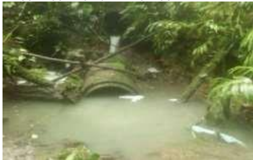
DESCARGA A LA QUEBRADA PITZARÁ CALLES: WILSON ROSALES Y JAIME ROLDÓS
