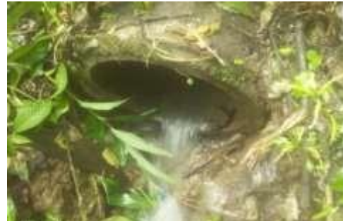
DESCARGA A LA QUEBRADA PITZARÁ CALLES: QUITO Y 14 DE FEBRERO
