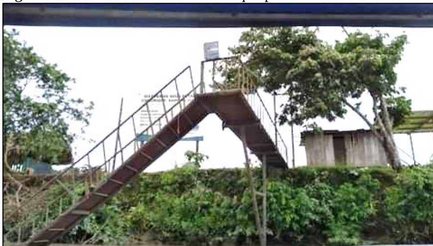
Figura N° 22. Instalaciones de embarque por el clima se deterioran.
