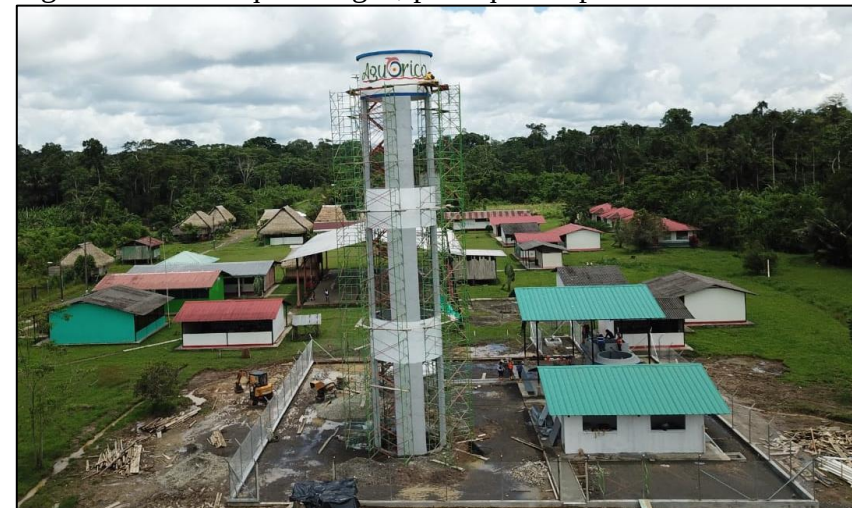
Figura N° 20. Tanque de agua, parroquia Capitán A. Rivadeneira.
