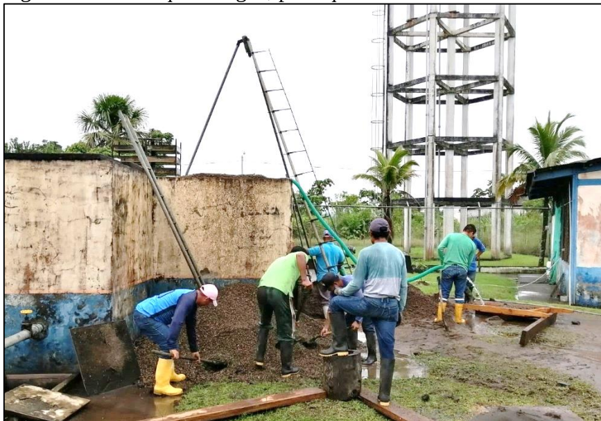
Figura N° 19. Tanque de agua, parroquia Nuevo Rocafuerte.
