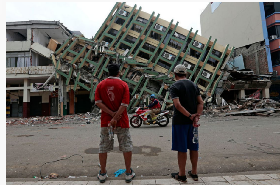
Figura 1: Colapso estructural posterior al terremoto de 2016 en Ecuador. Fuente: CNN en Español, 2017.
