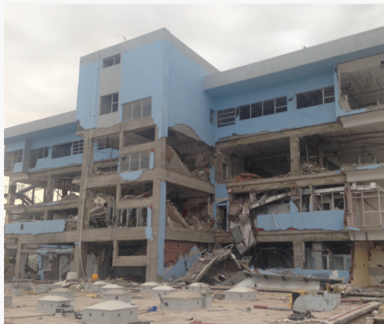
Imagen 1: Afectaciones infraestructura Hospital IESS Manta
