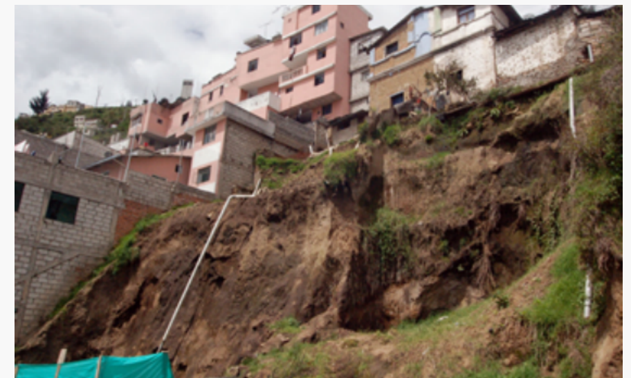
Figura 2: Ocupación residencial en ladera con signos de erosión e inestabilidad del talud, asociada a condiciones de exposición frente a procesos de remoción en masa.
